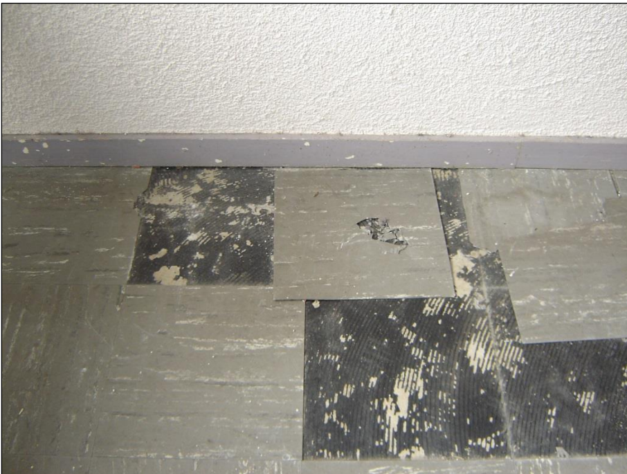
Asbesthaltige Bodenbeläge und Kleber
