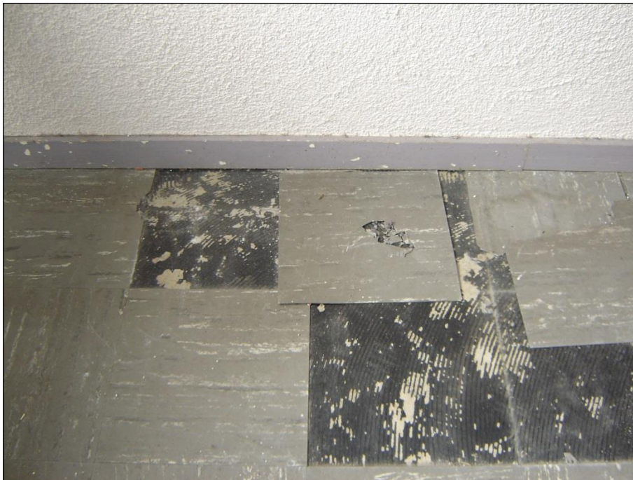
Asbesthaltige Bodenbeläge und Kleber
