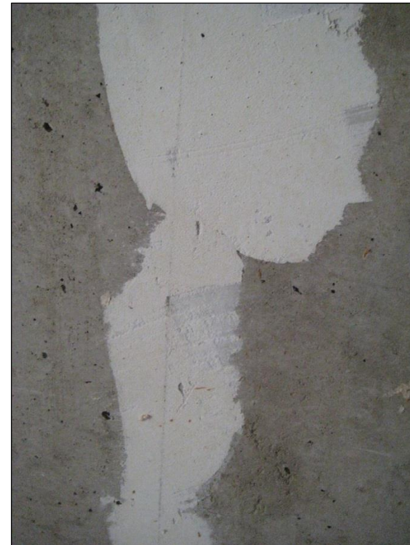
Asbesthaltige Putze und Spachtelmassen
